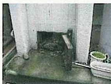
劣化（はく落した断熱材が点検口内に堆積）
